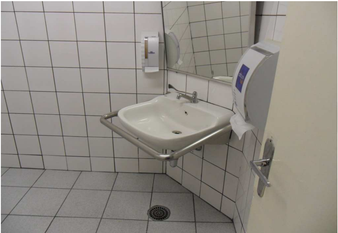
Foto 11 – Vista de um sanitário daquela edificação, em condição satisfatória de acessibilidade, notando-se a barra de apoio instalada ao redor do lavatório.
