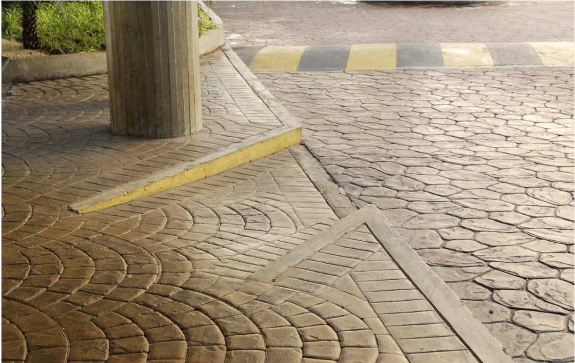
Foto 40 – Vista da guia rebaixada na entrada do Hotel Renaissance pela Alameda Jaú, permitindo o acesso de um usuário de cadeira de rodas.
