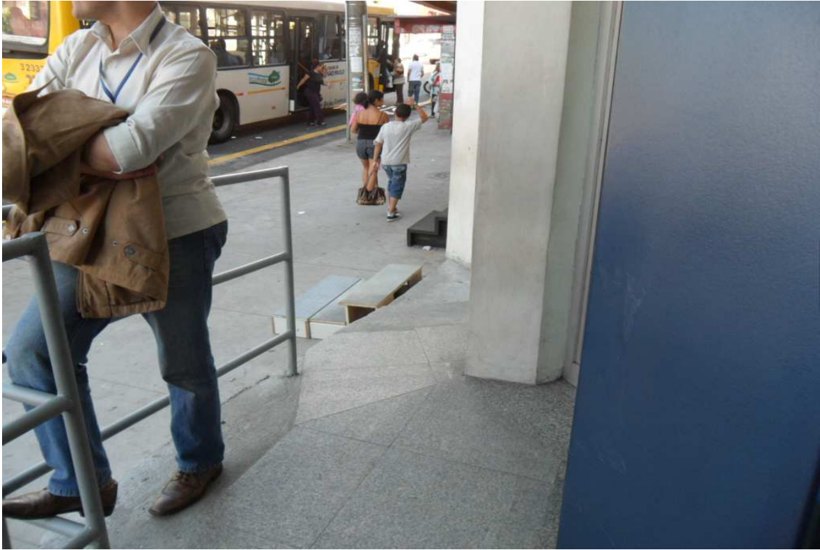
Foto 03 – Outro aspecto da falta de acessibilidade no acesso à edificação, observada no sentido da agência bancária para a via pública.
